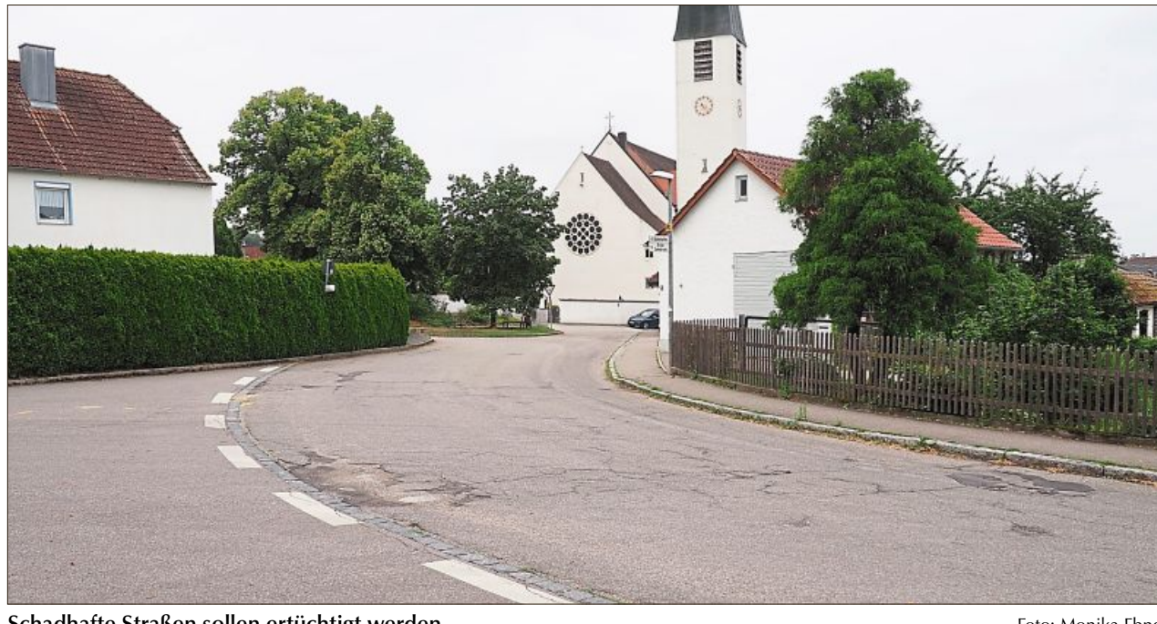
Schadhafte Straßen sollen ertüchtigt werden.
