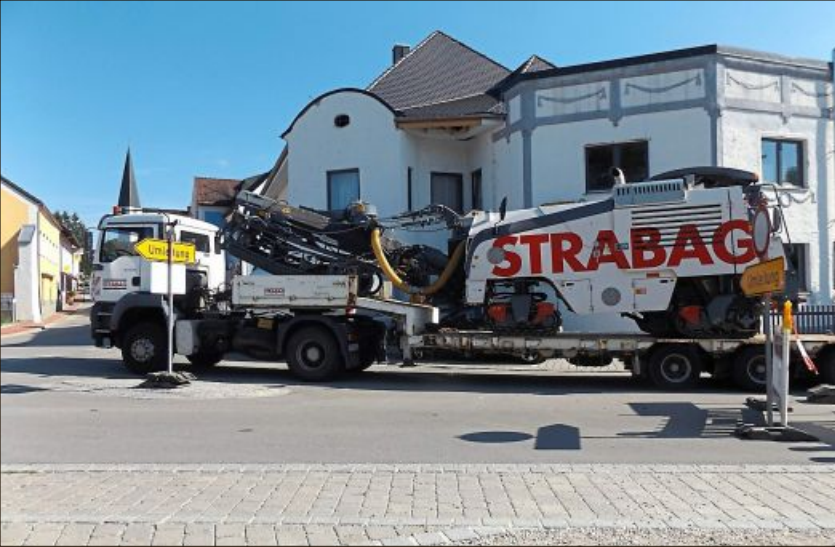
Bereits am Montag, 7. August erfolgten erste vorbereitende Arbeiten, um die Moserkurve zu entschärfen.
